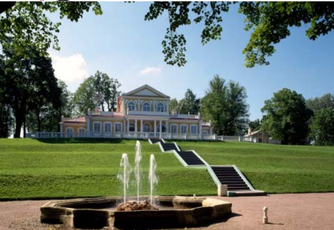
Реконструкция и реставрация Путевого дворца Петра I в Стрельне Авторы: архитекторы А.Г. Леяков, А.В. Лаврухин, Н.П. Величко, Л.А. Хангу, конструктор И.М. Герман, инженеры В.Д. Синьков, И.А. Акопян
